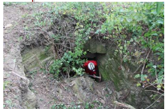
Dopo aver liberato l'ingresso dalla vegetazione, si eseguono alcuni lavori per agevolare l'entrata nella parte ipogea della galleria.
